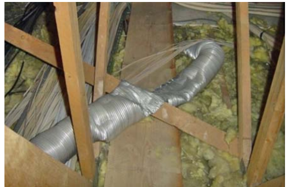
Défaut de mise en œuvre des gaines de ventilation.
